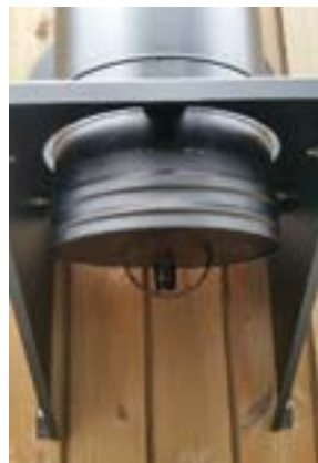
Feieluke med kondensuttak i bunn av pipeløp
