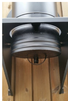
Feieluke med kondensuttak i bunn av pipeløp
